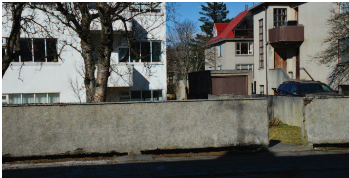
Mynd 22.12. Landsig í Norðurmýrinni í Reykjavík vegna framræslu. Mýrin hefur sigið við húsið og unnið er að viðgerð (fyrir ofan) en landið hefur sigið niður fyrir girðinguna á myndinni fyrir neðan svo að gapir undir hana.
